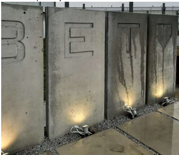
Rys. 9. Po lewej mury zaimpregnowane, po prawej bez impregnacji
