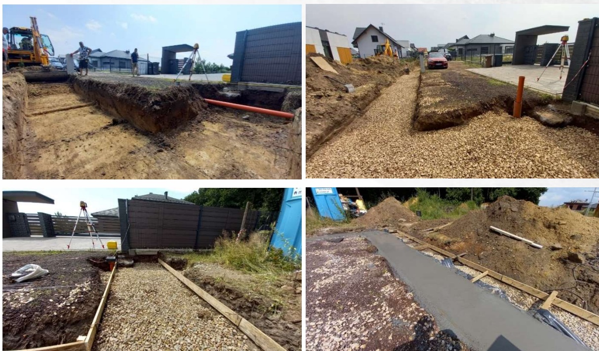
Rys. 2. Kolejne etapy wykonania podbudowy muru ogrodzeniowego (korytowanie, zasypanie kruszywem, przygotowanie szalunku, zalanie betonem).
